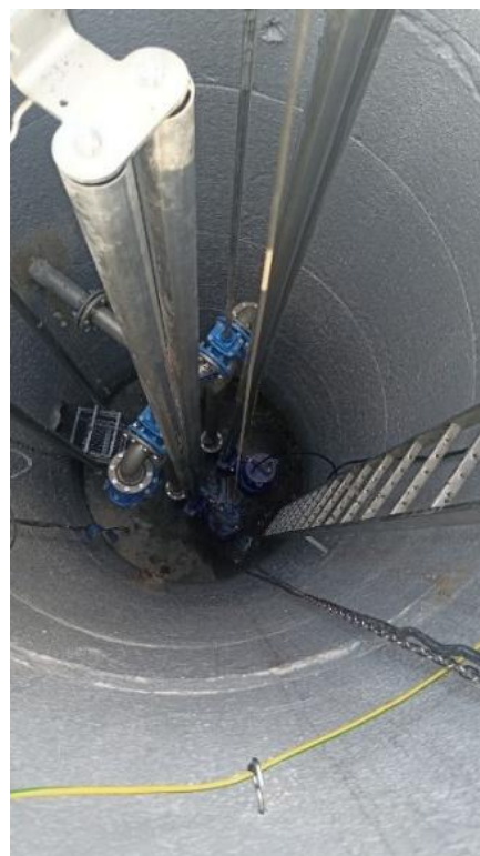
Elementy zmodernizowanych przepompowni ścieków
